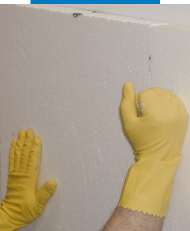
Εφαρμόστε πίεση στις μονωτικές πλάκες μόλις τοποθετηθούν. Έτσι εξασφαλίζεται η καλύτερη συγκόλληση στο υπόστρωμα
